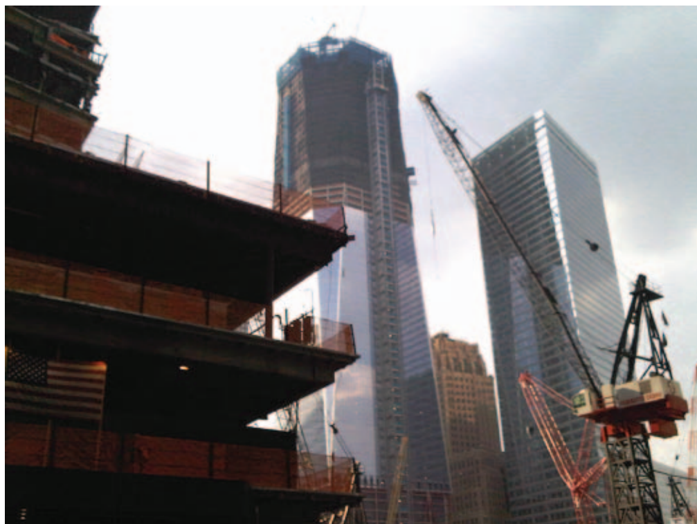
▲ Construcción de la Freedom Tower, en Nueva York, proyecto que sustituye a las Torres Gemelas y se espera concluya en enero de 2013.
